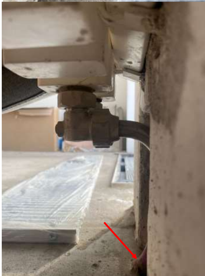
Подводка радиаторов не утоплена в стену.
