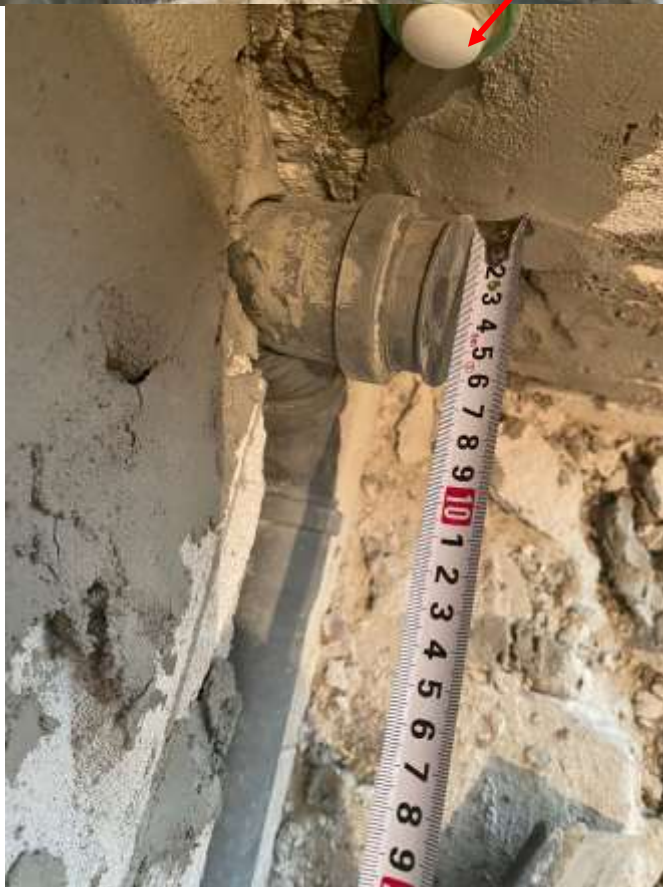
Диаметр трубы не соответствует трубе под стиральную машинку.
