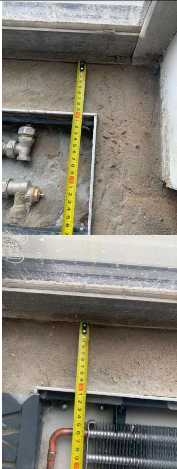
Напольный конвектор установлен не симметрично относительно окна.
