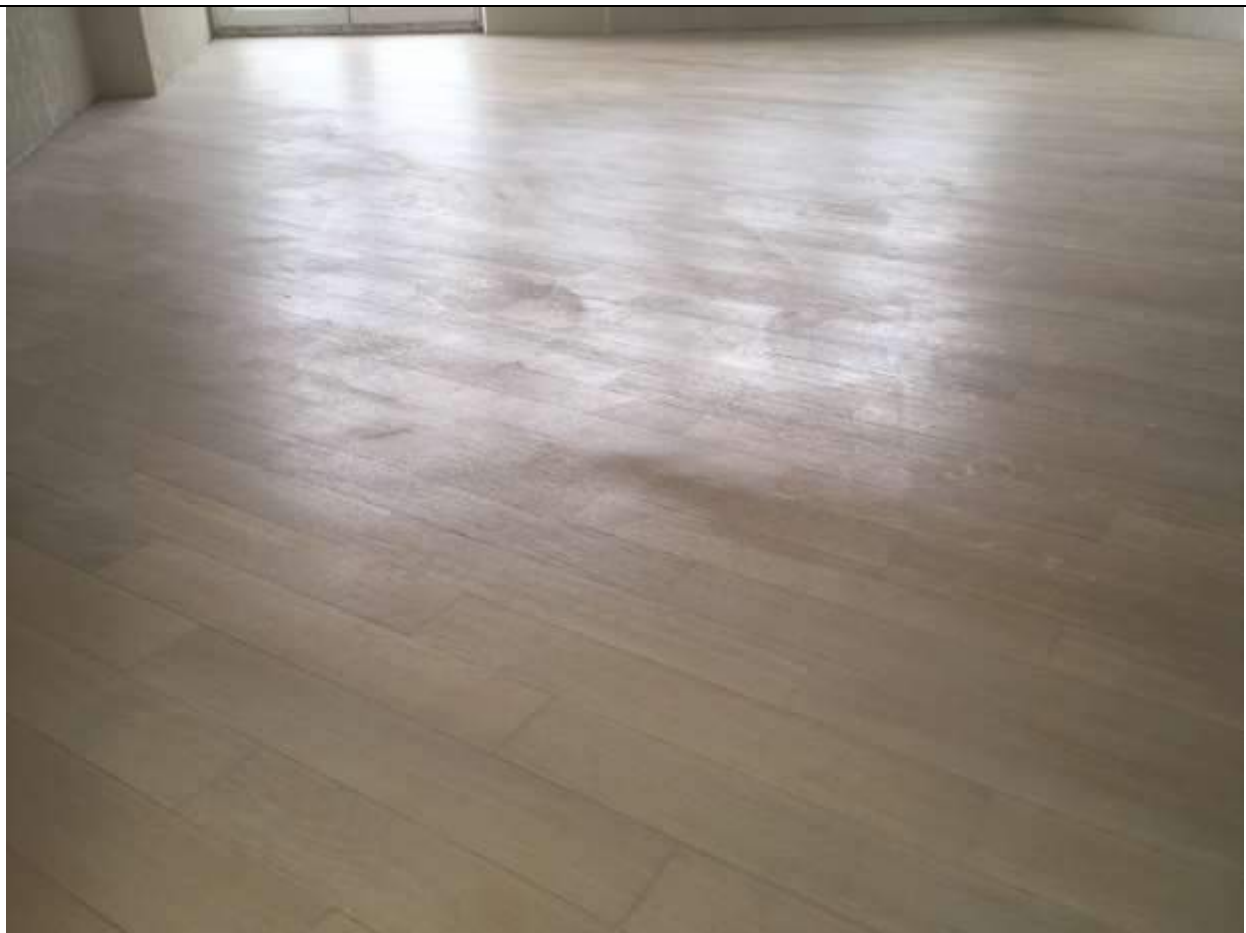
Разводы, не равномерное нанесение окрасочного слоя.
