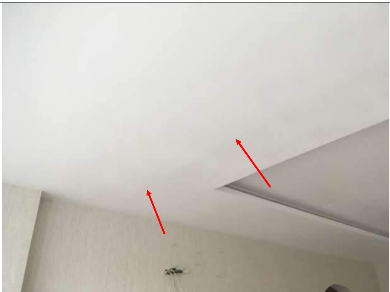
Искривление линии окраски поверхности потолка.
