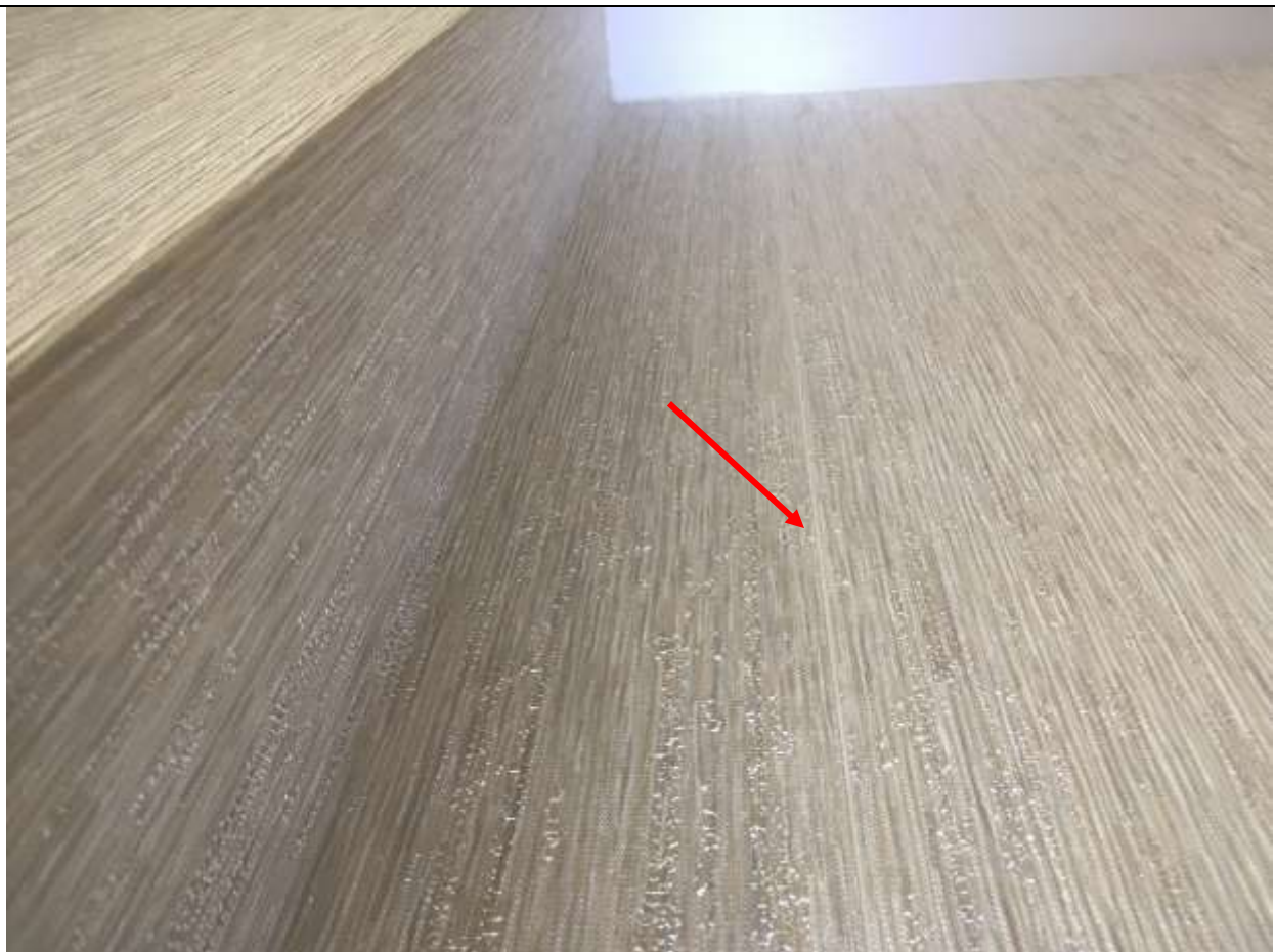
Зазор в обойном полотне.
