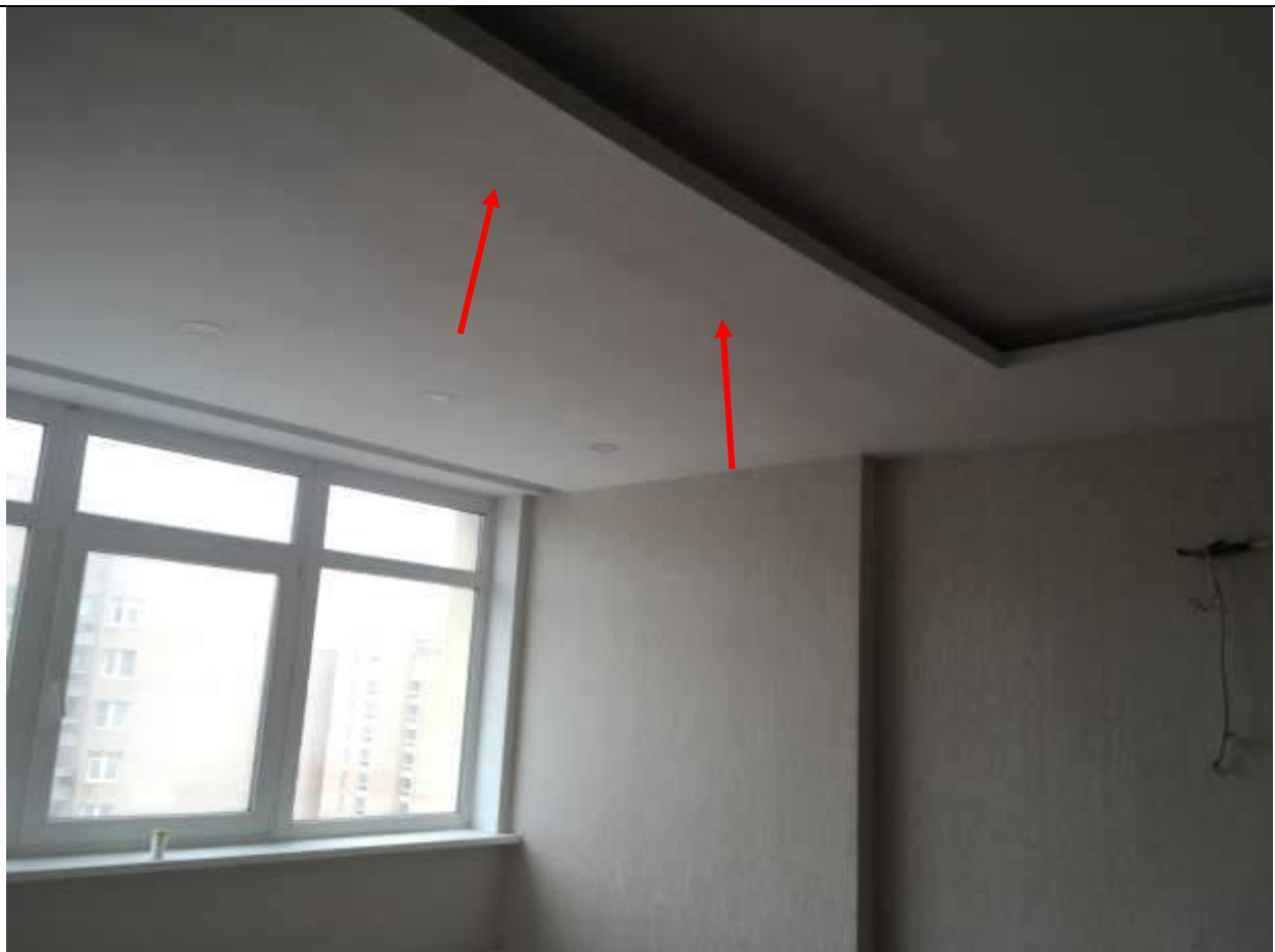
Искривление линии окраски поверхности потолка.
