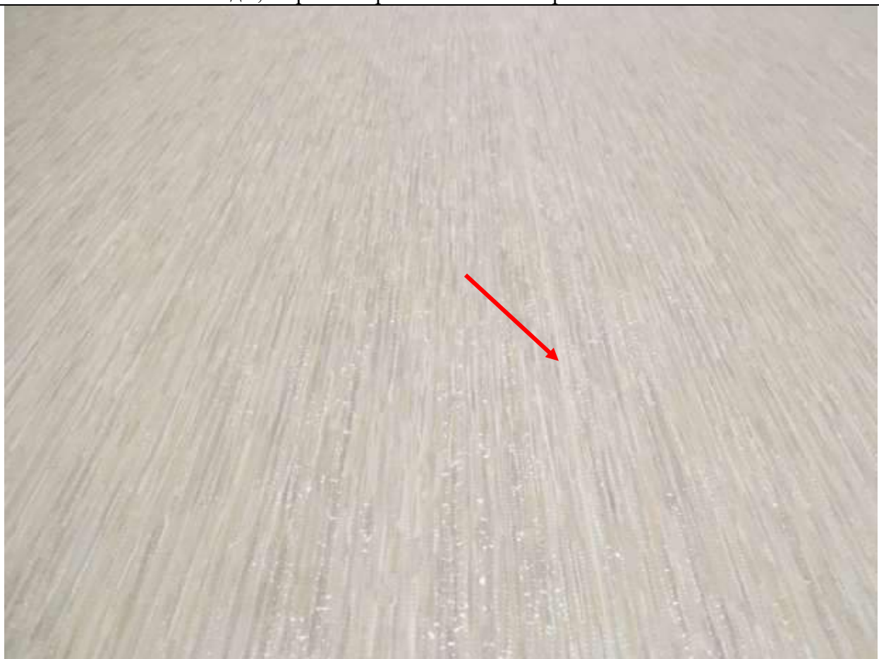
Зазор в обойном полотне.
