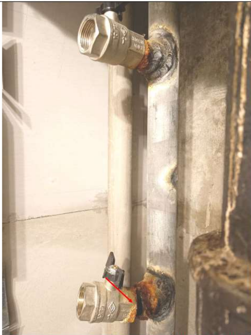
Место срыва общедомового вентиля ГВС (шарового крана на полотенцесушитель). Коррозия на вентиле.
