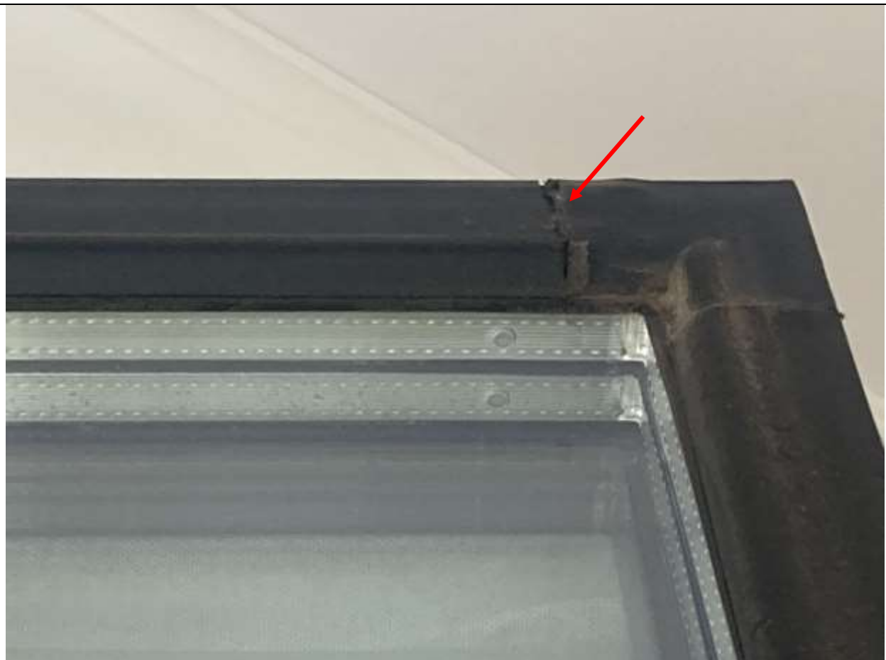
Расхождение элементов облицовки со стороны улицы.
