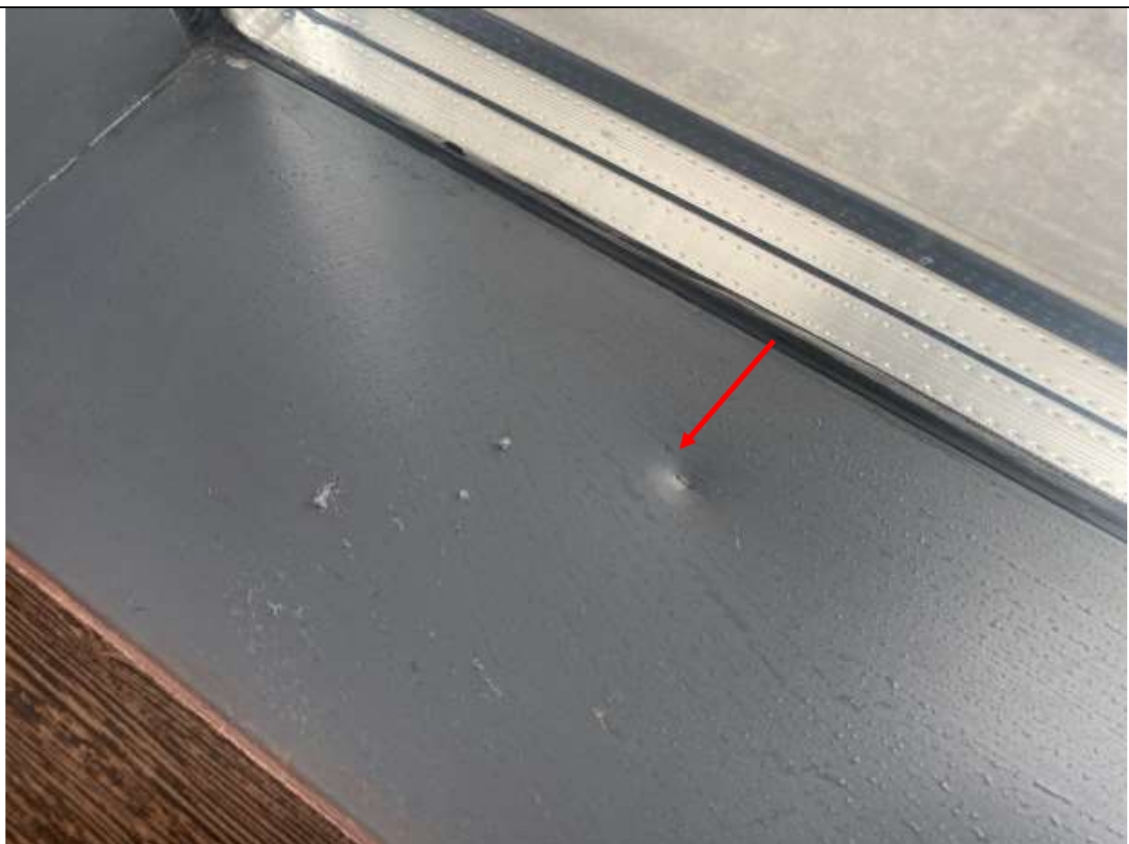
Повреждения поверхностей профиля.
