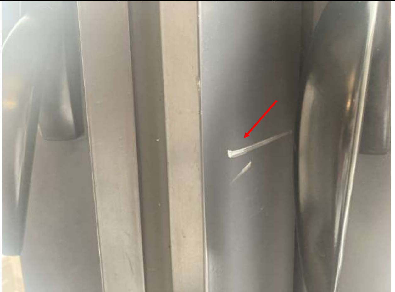
Повреждения поверхностей профиля.
