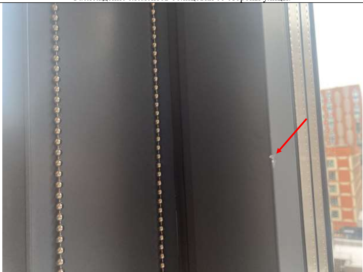
Повреждения поверхностей профиля.
