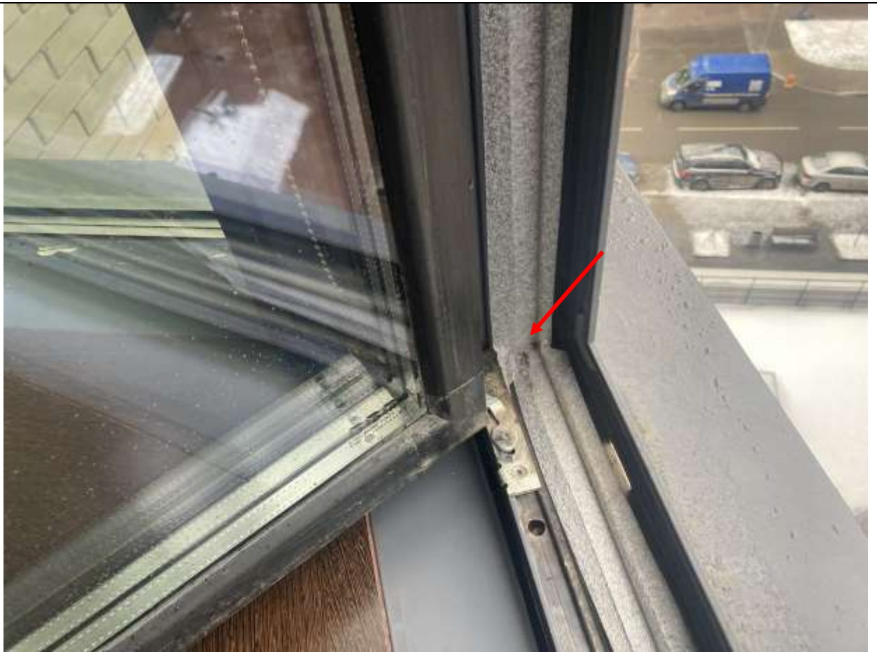
Отсутствует механизм открывания створки.
