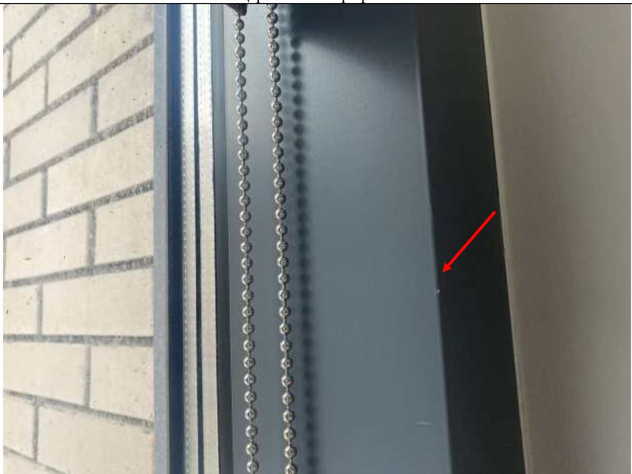
Повреждения поверхностей профиля.
